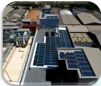
Comercial SAAN Sistema Híbrido de 44,55 kWp
