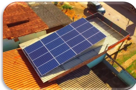
Residencial - Luziânia Sistema de 7,92 kWp
