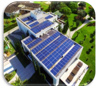
Residencial - Lago Sul Sistema de 41,54 kWp
