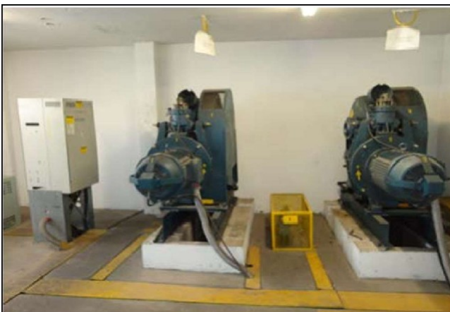
CASA DE MÁQUINAS
